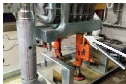
Hubmännchen am Rücklaufrohr
