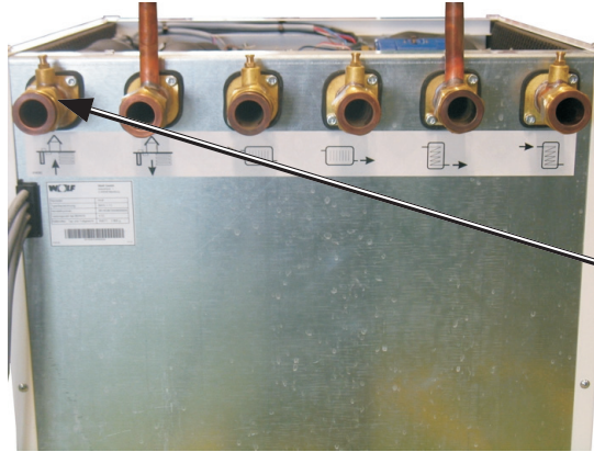
Handentlüfter im Sole-Eintritt
