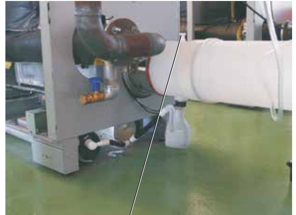
Messöffnung an der Kondensatfalle
