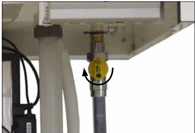
Figura: Conexión de gas Peligro por intoxicación y explosión por escape de gas
