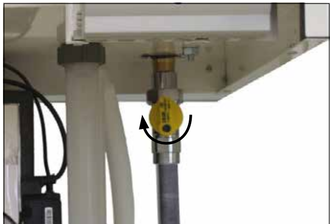
Billede: Gastilslutning Fare for forgiftning og eksplosion pga. udstrømmende gas
