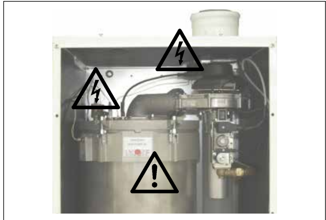
Bild: Zündtrafo, Zündelektrode, Wärmetauscher Gefahr durch elektrische Spannung, Gefahr von Verbrennung durch heiße Bauteile
