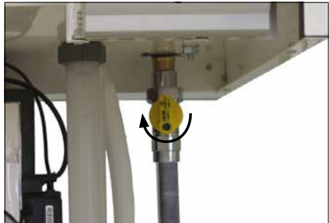
Εικόνα: Σύνδεση αερίου Κίνδυνος δηλητηρίασης και έκρηξης λόγω διαρροής αερίου
