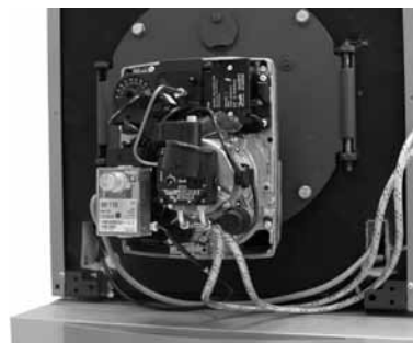
Recorrido de cables quemador - caldera
